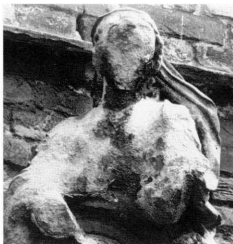
Figure 23.18 A monument before and after deterioration caused by acid rain. [Westfälisches Amt für Denkmalpflege.]
